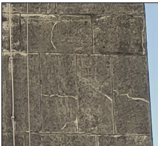
34. ábra: repedések a burkoló köveken
