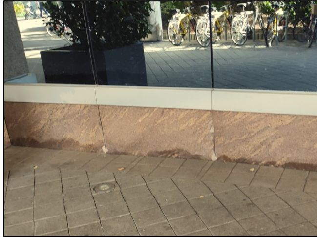
19. ábra: Károsodás, elszíneződés a lábazati részen
