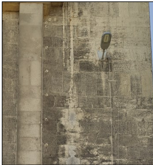
33. ábra: Elszennyeződött homlokzat
