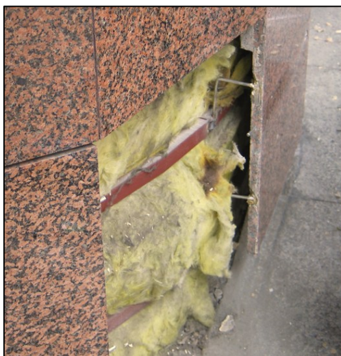
3. ábra: A valós mechanikai igénybevételnek nem megfelelő vastagságú gránit lapburkolat lábazati zónában, egyedi kialakítású rögzítővel. A fotón a laza, alacsony testsűrűségű szálas hőszigetelés károsodása is megfigyelhető.
