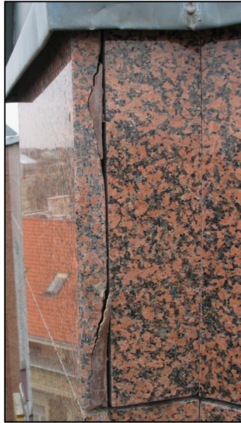
32. ábra: kitöredezett, elvált ragasztás a tüske környezetében
