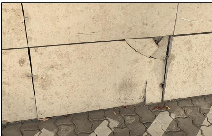
18. ábra: Tönkremenetel erős mechanikai igénybevétel miatt. Lábazati részen károsodott kő
