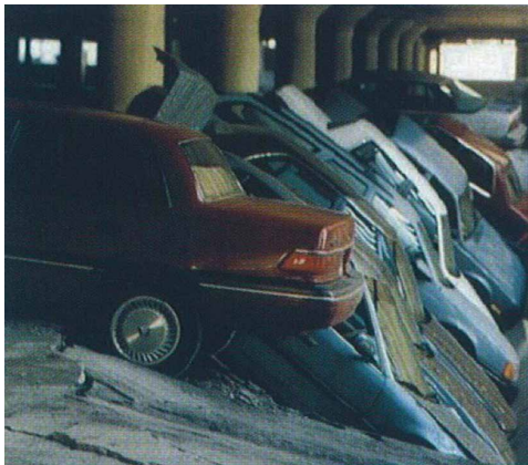
11. ábra: Leomlott parkolófödém az USA-ban (Forrás: store.amp.org/04345-improved-current-distribution-due-to...)
