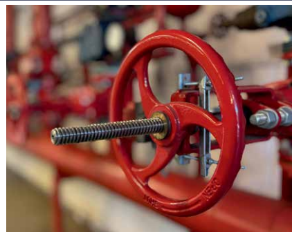
Aktív gépészeti rendszer: sprinkler rendszer
