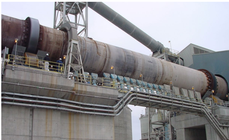
16. ábra: Cementégető kemence
