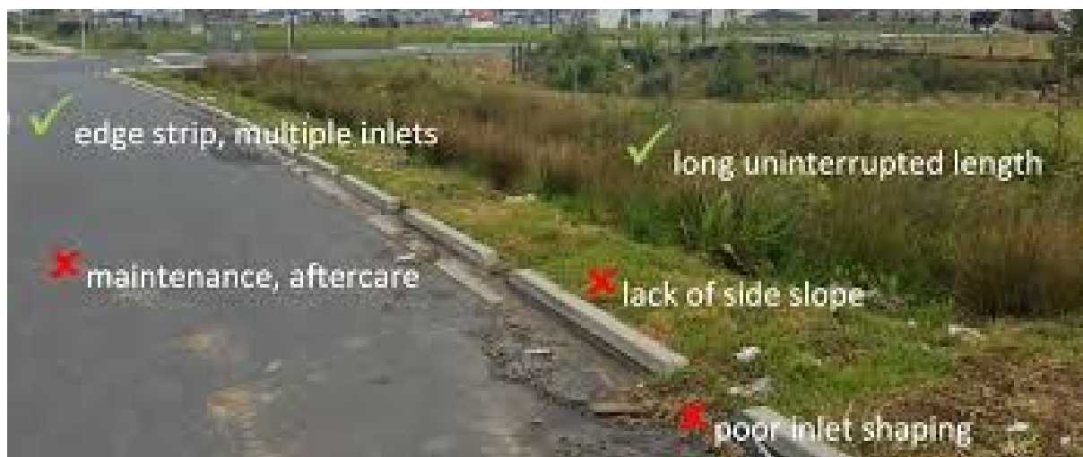
18.kép: a surrantó környezetében lévő növényzet akadályozza a bevezetést
