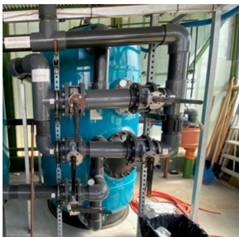
40.sz. ábra Nyomás alatti gyorszűrő beépítve
