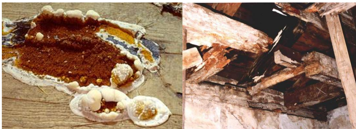
11. ábra Könnyező házigomba és az általa okozott födémleszakadás
